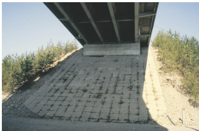
Kuva 18. Korkeahko betonilaattaverhoaminen etuluiskassa.
