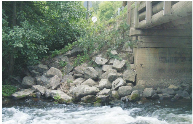
Kuva 9. Perustusten peittämisen vuoksi vaurioitunut keila.
