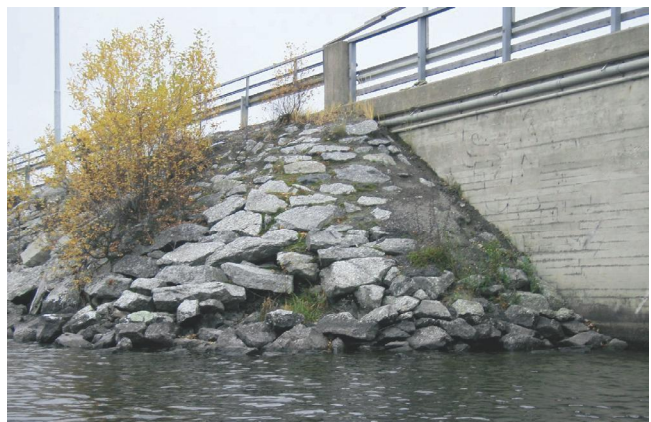
Kuva 10. Verhouksen juuri on vaurioitunut.
