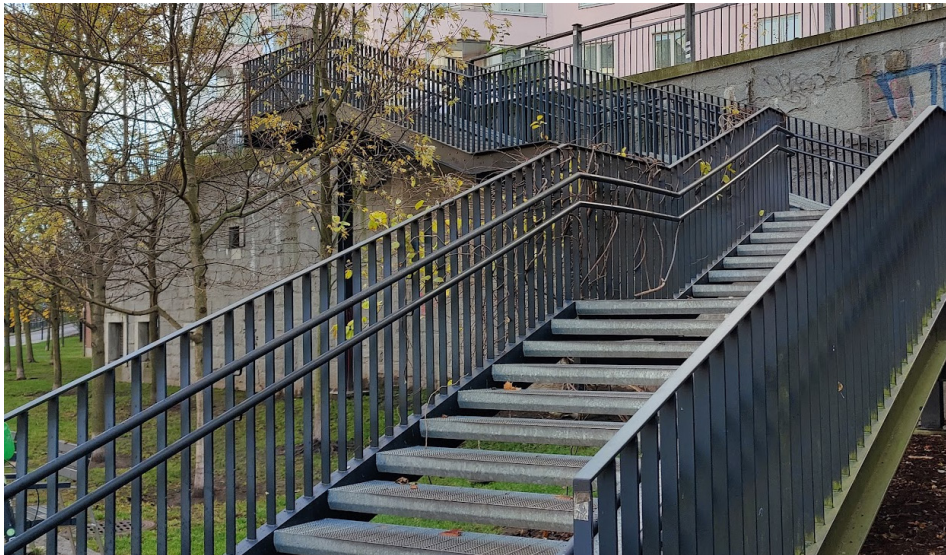
Baanalla sijaitseva teräsrunkoporras ritiläaskelmalla.
