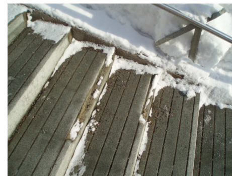
Lämmitettyjen massiivikiviportaiden tyypillinen vikatilanne on, että eroosio lohkaisee askelman etureunasta osan lämmityselementin uran kohdalta.
